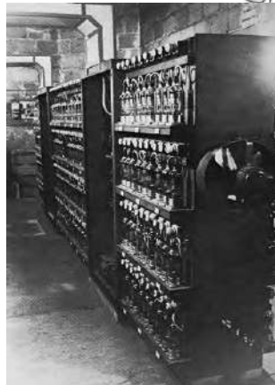
Стойка тиристорных силовых блоков
